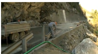
Die Strasse muss neu gebaut werden
