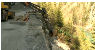
Strasse verschüttet, 1 Toter
